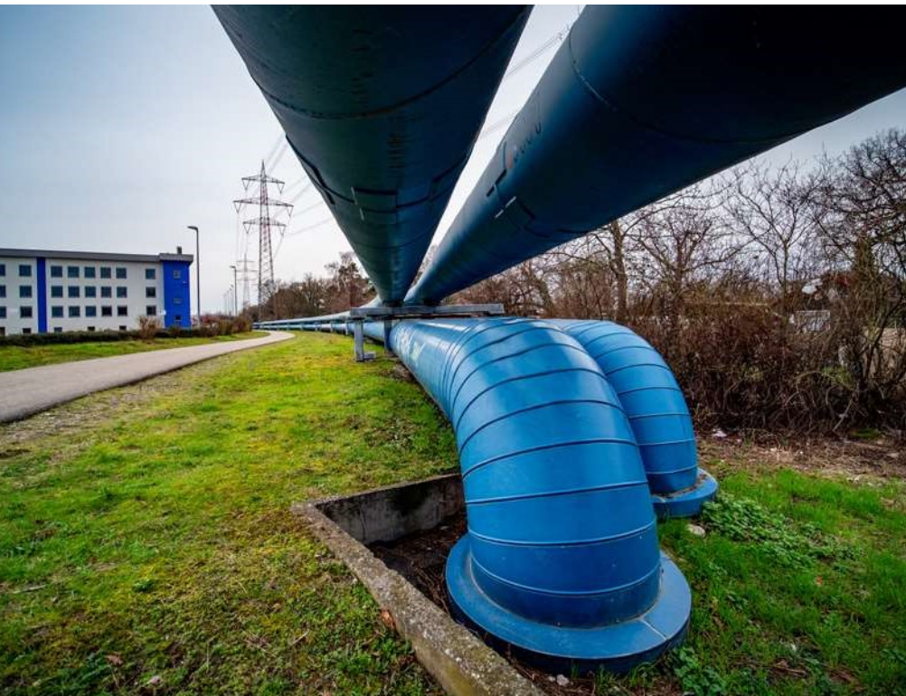
Effiziente Wärmeversorgung: Eine Fernwärmeleitung transportiert nachhaltige Energie für Haushalte und Unternehmen.
